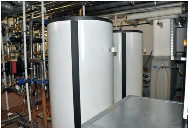
Die Frischwasserstation Remeha HFS 750 in zweifacher Ausführung versorgt das Krankenhaus mit Trinkwasser.
