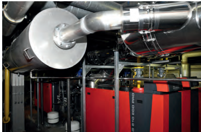
An die neue Abgasleitung wurden sämtliche Wärmeerzeuger angeschlossen. Schalldämpfer mindern die Abgasschallemissionen des neuen BHKWs.
