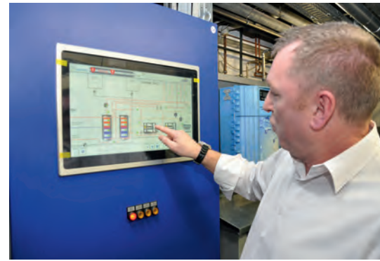
Ein Blick auf die Steuerung der Frischwasserversorgung, die speziell für die Anlage in Damme konzipiert wurde.
