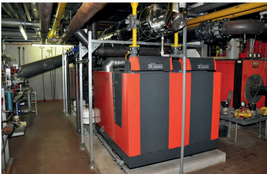
Das Krankenhaus St. Elisabeth in Damme hat ein modernes Heizkonzept realisiert. Ein Teil besteht aus einer Kaskade von vier Brennwertkesseln des Typs Remeha Gas 610 Eco. Bilder: Remeha
