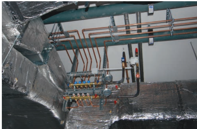
Die Hypoplan-Elemente, die sich auf Ebene 0 befinden, werden durch Verteiler im Untergeschoss angebonden.
