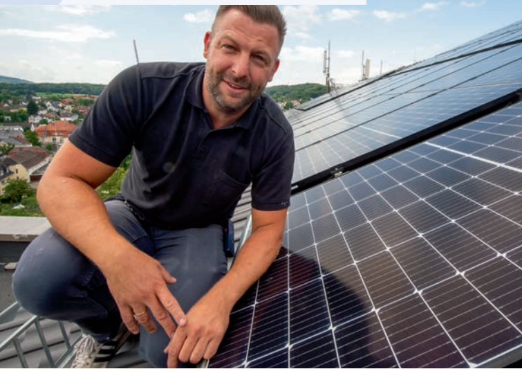
Werkstattdirektor Thorsten Lisdau mit einem Teil der Photovoltaik-Anlage mit 76 kWp Leistung. Der produzierte Strom deckt jedoch lediglich rund zehn Prozent des jährlichen Strombedarfs der Klinik.
