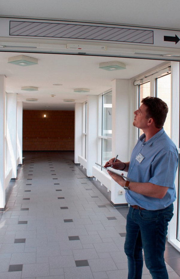
Die Funktionsprüfung der Brandschutztüren am Kreiskrankenhaus Prignitz wird monatlich durchgeführt und in der Kevox-Managementsoftware dokumentiert.
