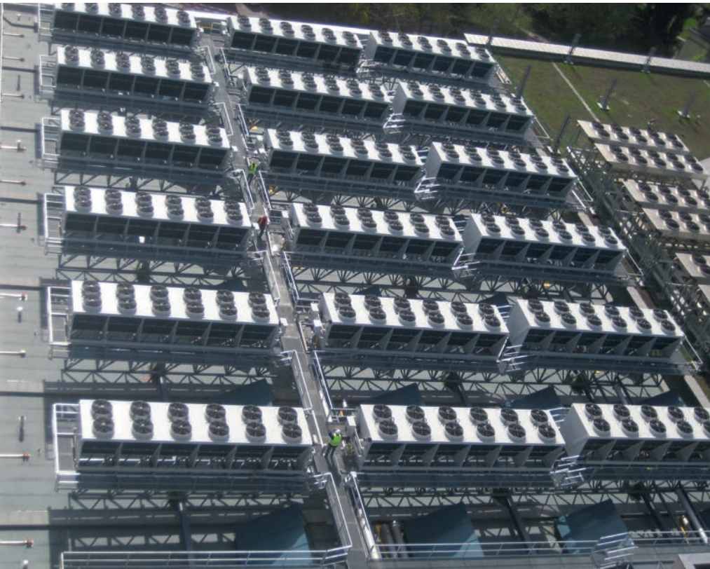
Rückkühler auf dem Dach des Inselspitals in Bern: Betreiber von Kälte- und Klimaanlage sind sowohl nach alter als auch neuer F-Gase-Verordnung verpflichtet, größte Sorgfalt walten zu lassen, was die Dichtheit der Anlagen betrifft.
