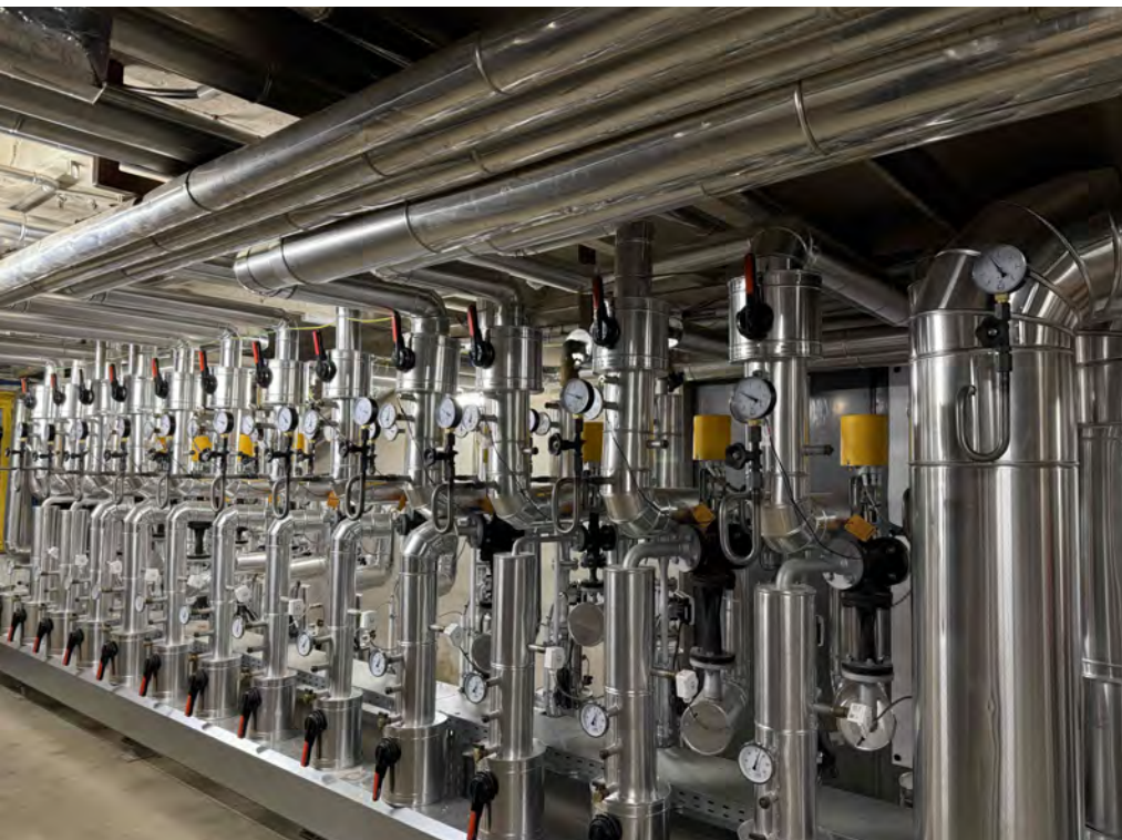
Heizungsanlage am Landeskrankenhaus Hollabrunn: Der verwendete Heizungsverteiler Hydropilot von Baelz mit Strahlpumpen-Aufbaugruppen ist eine fertig montierte Anlage für die Leistungsregelung von Heizungsverbrauchern und Heizregistern.
